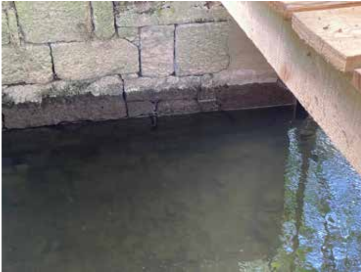
Deutlich unterschrittene Staumark eines Wasserkraftwerks an der Jagst
